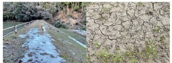
写真左：堤体に損傷があるため池
